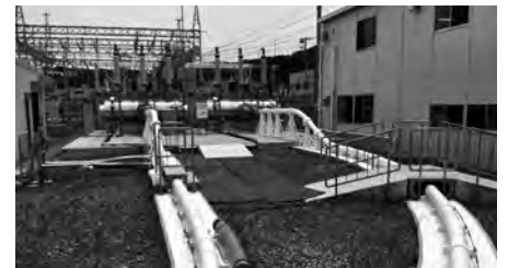
東京電力(株)旭変電所超電導電力ケーブル実証試験現場
