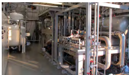
旭変電所に移設したブレイトン冷凍機
